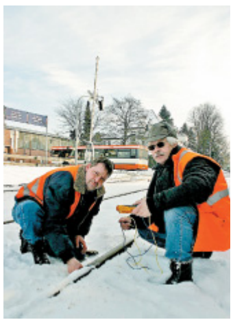
Test: Thorsten Siebert (l.) und Horst Ellerbrock, der einen Multi-meter in der Hand hält, auf den Schienen am Queller Bahnhof. Mit dem Gerät misst der Mitarbeiter von DB Regional, ob die Kontakte für die automatische Schrankensteuerung in Ordnung sind.
